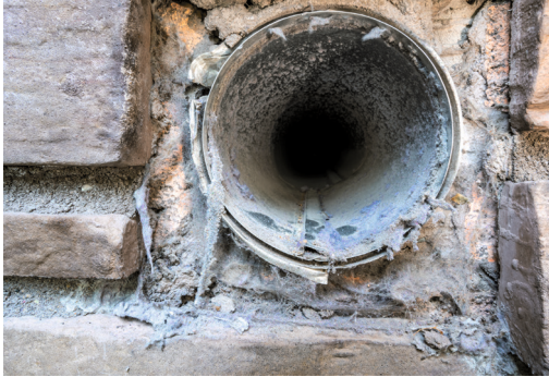
Encrassement du conduit d'évacuation d'air
