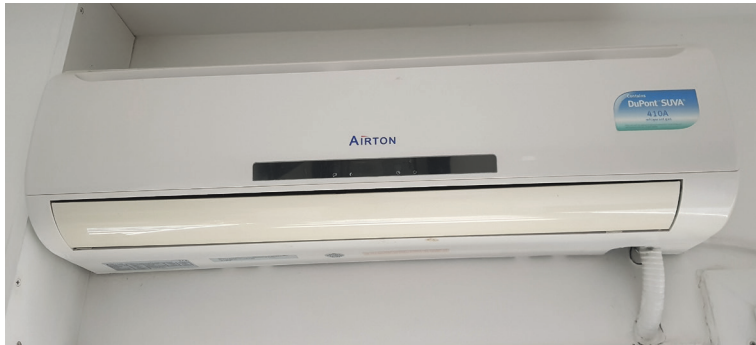
Unité intérieure de climatiseur
