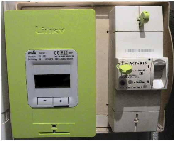
Compteur divisionnaire et disjoncteur principal
