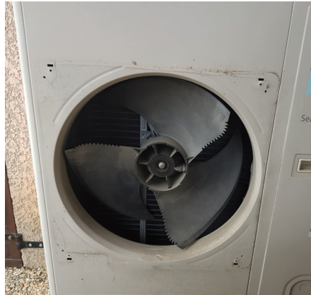
Ventilation de refroidissement d'unité extérieure.
