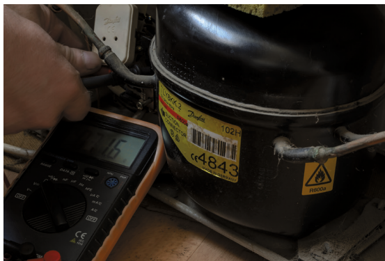
Test du relais d'un compresseur
